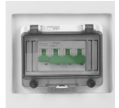
Sicherungen auf der rechten Seite der Batterie
