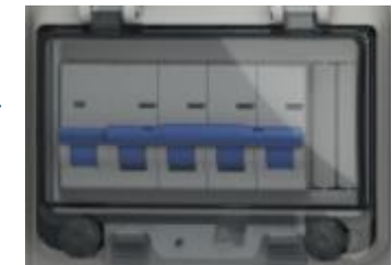
Sicherungen auf der linken Seite der Batterie
